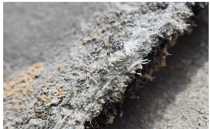
Mynd 5.16 Asbest er dæmi um hættulegt efni sem getur fundist við niðurrif eldri bygginga. Bannað er að flytja það inn eða nota og einungis má fjarlægja það og farga því.
