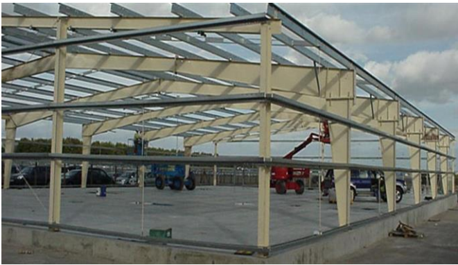
Mynd 5.10 Á myndinni má sjá stálgrind byggingar. Stálgrind hússins hafði verið notuð í annarri byggingu en var tekin niður, sett í geymslu og síðan sett upp aftur.
